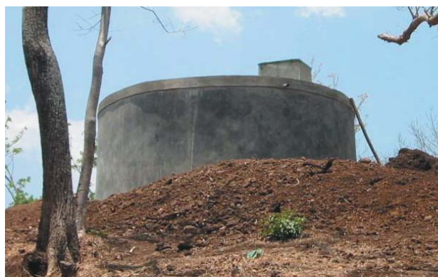
Tanc de distribució d'aigua per gravetat amb clorador a la part superior
